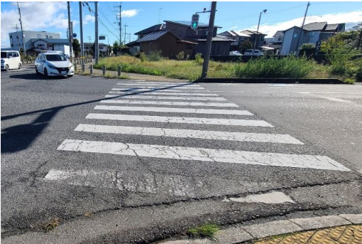
R7-12 横断歩道が消えかかっている
