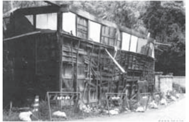
堀ノ内地区内の崩壊家屋 (写真は平成20年4月。現在は解体済み。)
