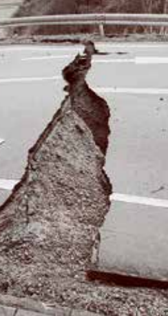
▲東日本大震災で亀裂の入った道路
