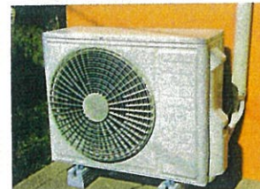
エアコン室外機
