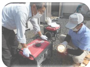
投光器で発電確認
