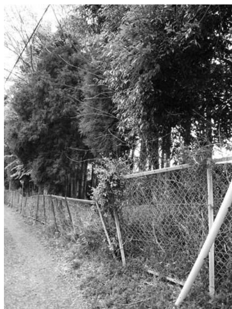
傾きが見られる那珂一中のフェンス
