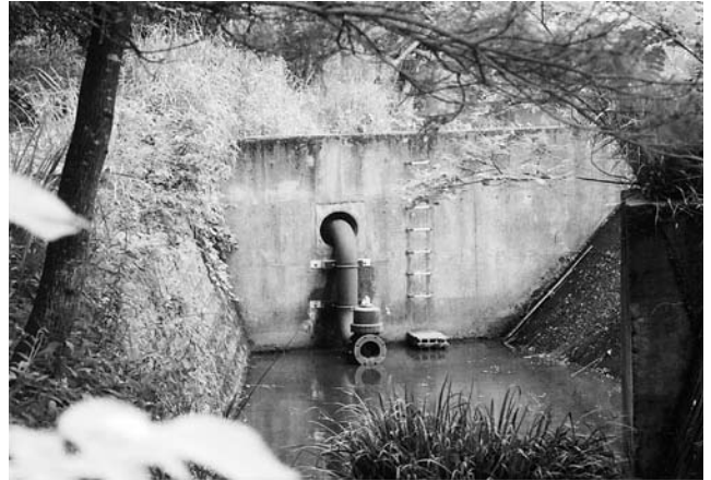
サイフォン式の排水施設（大気圧を利用し、液体を一度高い所に上げてはじめての位置より低い所に移す排水施設）
