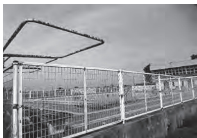
老朽化の進む芳野小学校及び那珂第三中学校プール
