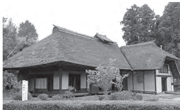
屋根の損傷が目立つ曲がり屋
