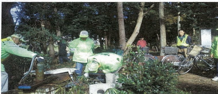
発電機による自動給水と手動井戸ポンプの復旧完了
